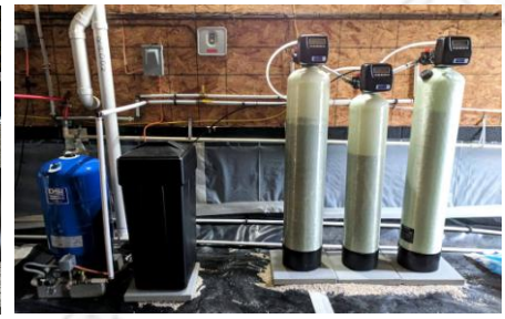
ปรับสภาพน้ำโดยให้น้ำผ่าน เครื่องปรับแต่งสภาพน้ำ
